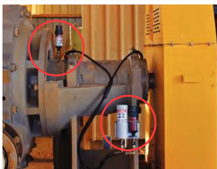
Lubrification du palier & du joint d'une pompe
