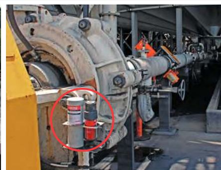
Lubrification du palier & du joint d'une pompe
