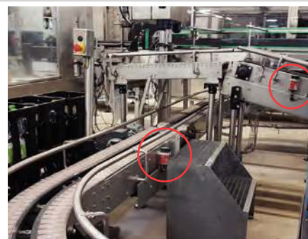
Lubrification de chaîne pour le transport de caisses après l'encaisseuse et le contrôle de caisse pleine
