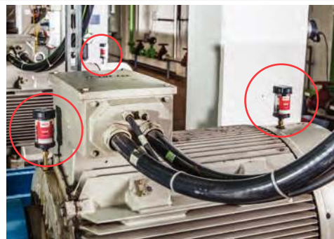
Lubrification de palier des moteurs électriques
