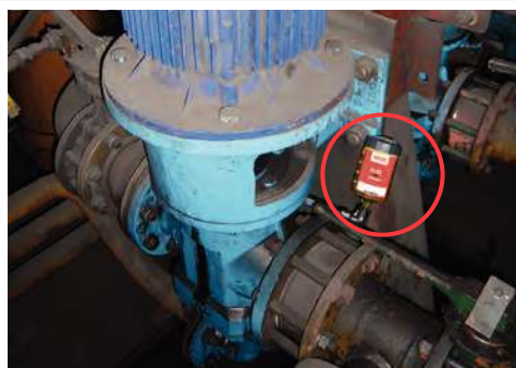
Lubrification d'une pompe à carburant dans le processus de raffinerie
