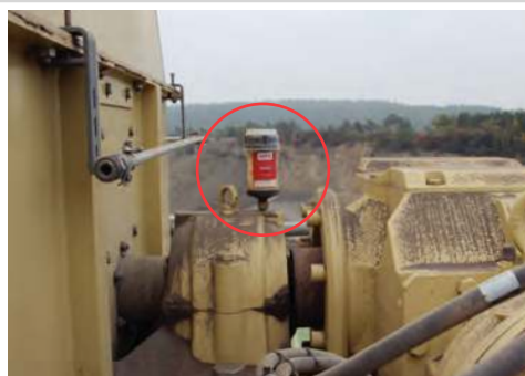
Lubrification de palier à roulement sur l'élévateur à chaud
