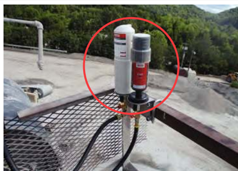
Lubrification du palier fonte d'un convoyeur
