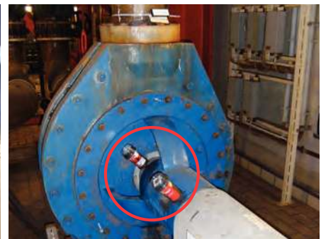
Lubrification de l'arbre moteur d'une pompe
