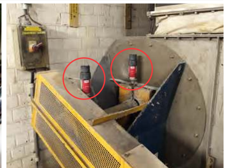
Lubrification de palier d'un dispositif de ventilation
