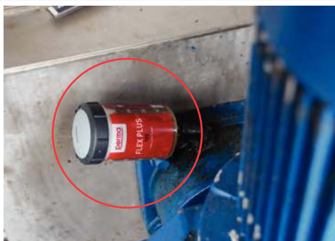
Lubrification du palier d'une pompe
