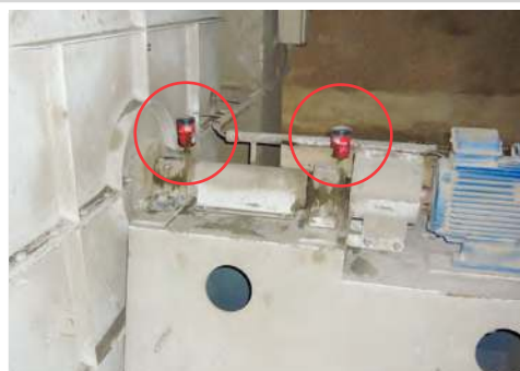
Lubrification du palier fonte sur l'arbre de ventilateur
