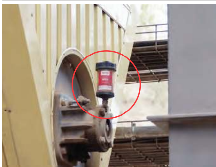
Lubrification du palier de pivotement sur le dépoussiérage de vis en auge
