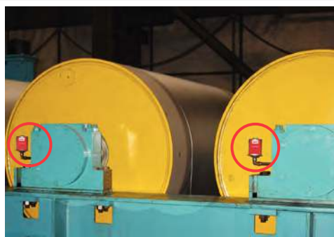
Lubrification de roulements à rotules sur rouleaux sur ligne de galvanisation à chaud
