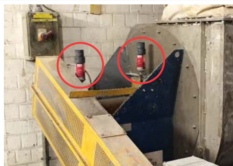
Lubrification du palier fonte d'un dispositif de ventilation
