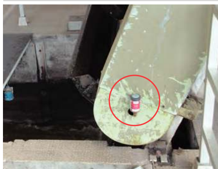
Lubrification de palier à roulement sur le galet de guidage de chaîne
